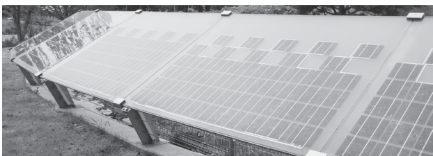
設置された太陽電池
